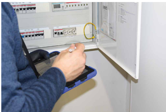
Abb. 1: Elektroverteilung [Quelle: TÜV SÜD]
