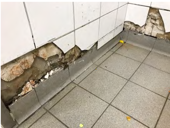
Abb. 1: Zwischenwand einer kernsanierten Großküche in Trockenbauweise: Zerstörter Fliesenbelag im Sockelbereich auf einer Gipskartonbeplankung ...
