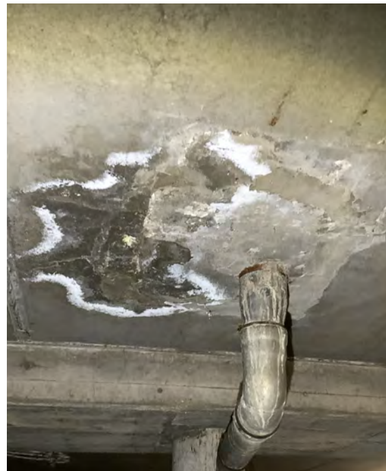
Abb. 4: ... und den zugehörigen Ausblühungserscheinungen im Untergeschoss
