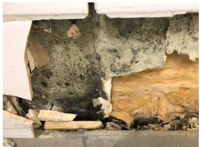
Abb. 2: ... mit aufgeweichten und brüchigen Gipskartonplatten und durchnässter Mineralwollendämmung
