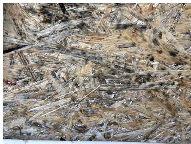
Abb. 4: Detailaufnahme mit sichtbarer Feuchtigkeit in der Holzwerkstoffplatte
