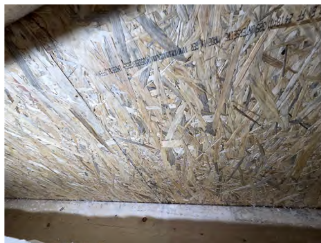
Abb. 5: Befallene und durchfeuchtete Konstruktion
