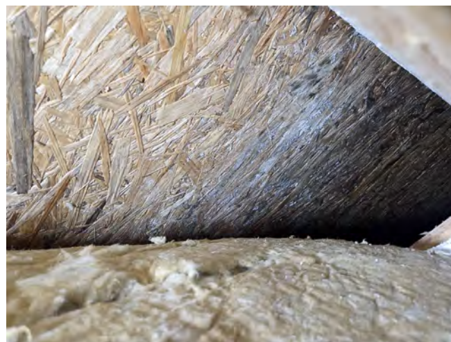
Abb. 3: Schimmelpilzbefall auf der Unterseite von OSB-Platten infolge Durchfeuchtung
