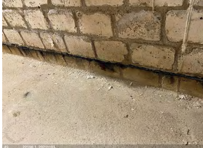
Abb. 4: Lösen einer (bituminösen) Horizontalabdichtung nach einer Überschwemmung mit Heizölaustritt
