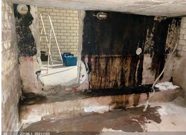
Abb. 3: Lösen einer (bituminösen) Schwarzabdichtung nach einer Überschwemmung mit Heizölaustritt
