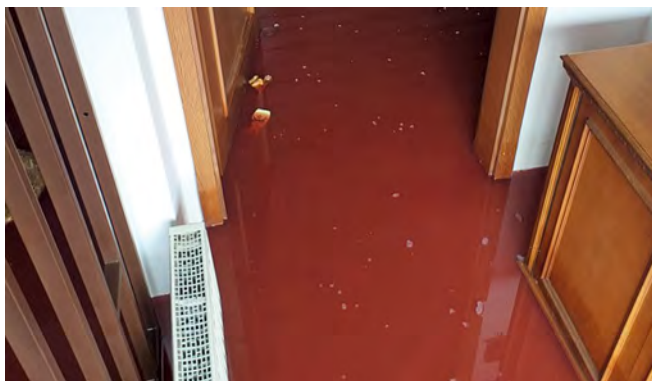
Abb. 1: Aufnahme zum Zeitpunkt der Überschwemmung im Erdgeschoss: Heizöl auf Wasseroberfläche [2]
