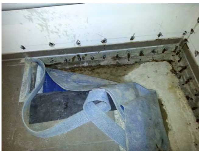
Abb. 4: Erneuter Wassereintritt nach erfolgter Injektage [Quelle: P. Schewe]
