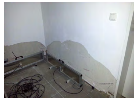
Abb. 1: Aufsteigende Feuchtigkeit an den Innenwänden [Quelle: P. Schewe]
