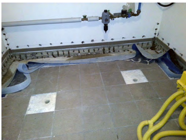
Abb. 3: Freigelegter Wandfuß [Quelle: P. Schewe]
